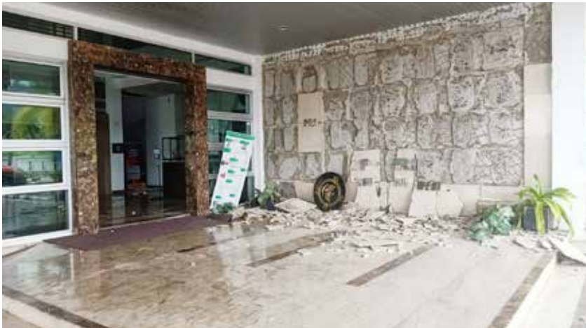
■ Kerusakan gedung BPK Perwakilan Sulbar akibat gempa tahun 2021.
